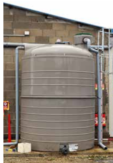
Cette cuve récupère jusqu'à 12 m³ d'eau de pluie
